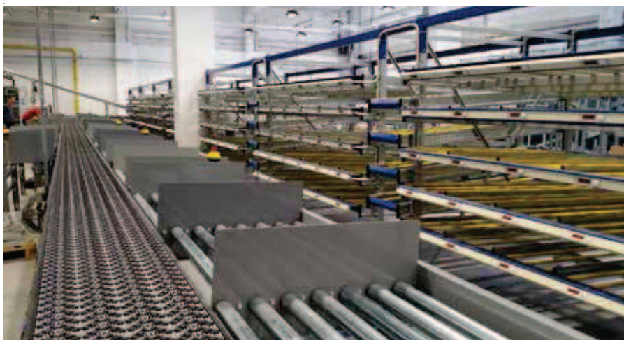
Fot. 1. Linia przesyłowa wyposażona w aktywne rolki kierunkowe i sloty sortujące
